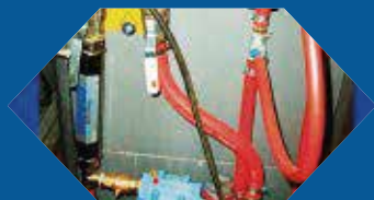
Chiller en industria
